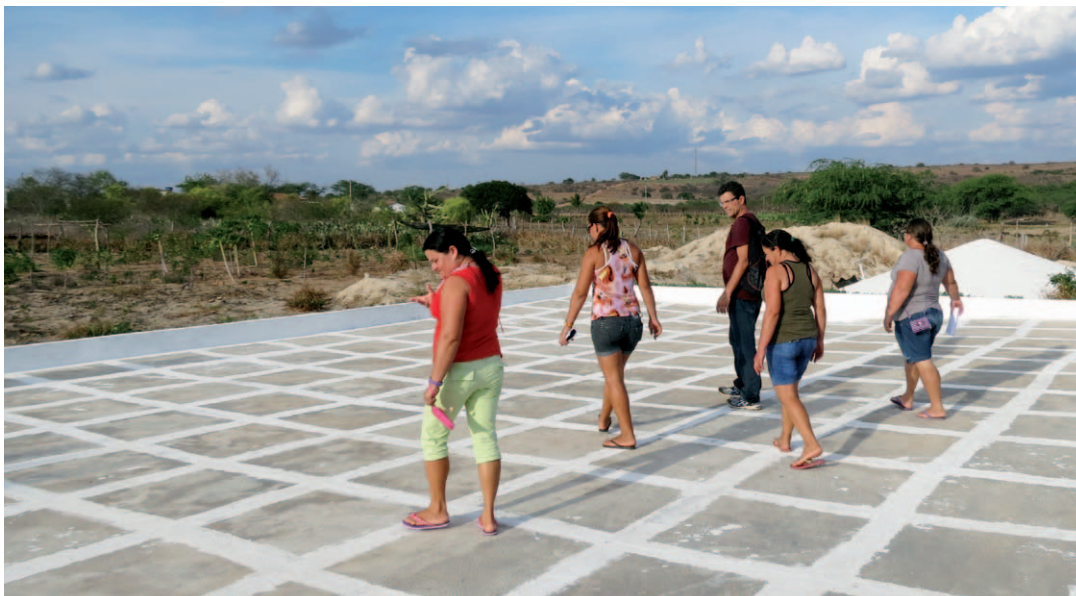
Cisternas de cemento son construidas para coleccionar el agua de las lluvias. © Matheus Alves Zanella
